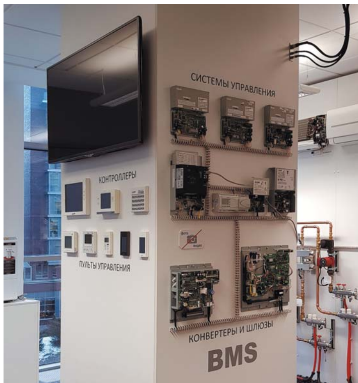
СИСТЕМЫ УПРАВЛЕНИЯ И ШЛЮЗЫ
